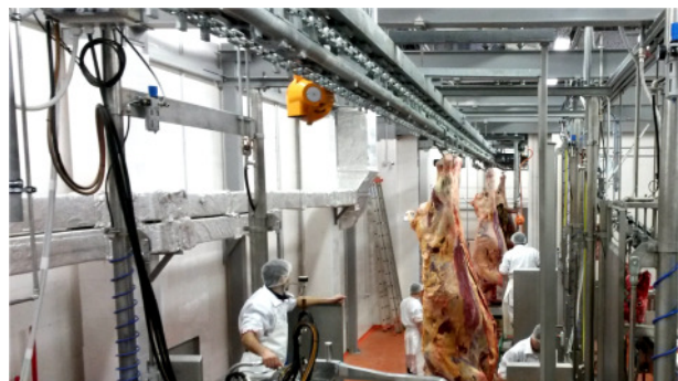
Ausschlachtlinie mit autom. Förderanlagen (Rind)
