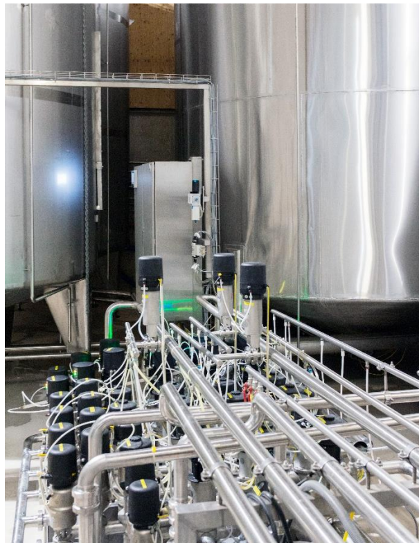
Tanklager mit Ventilknoten
