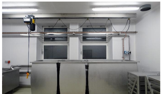
Salzbadanlage mit Klapphorden und Krananlage
