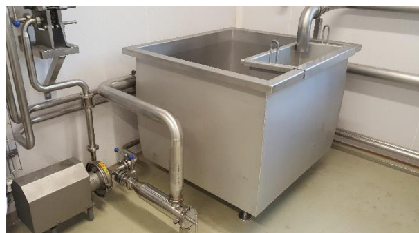
Ausgleichswanne mit Grobfiltern, Umwälzpumpe und Plattenkühler
