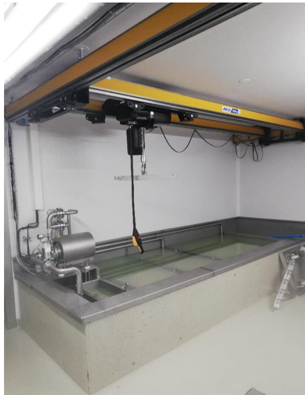
Tiefensalzbad mit 3D-Krananlage
