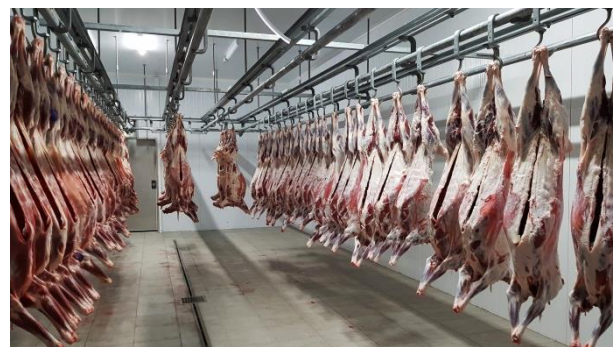
Abkühl- und Lagerkühlräume
