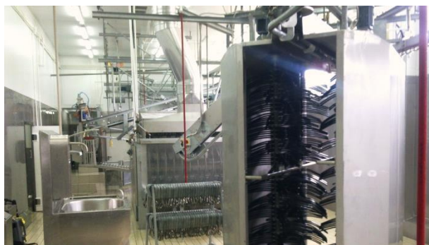
Установка вторичной зачистки
